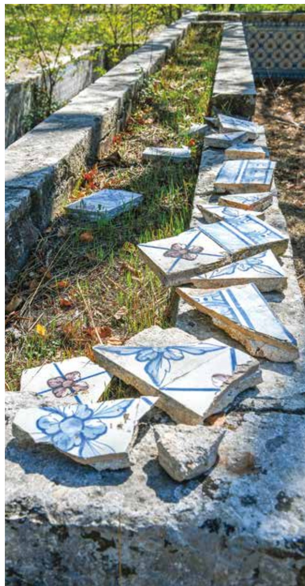
Estado de degradação dos azulejos na Casa da Pesca
