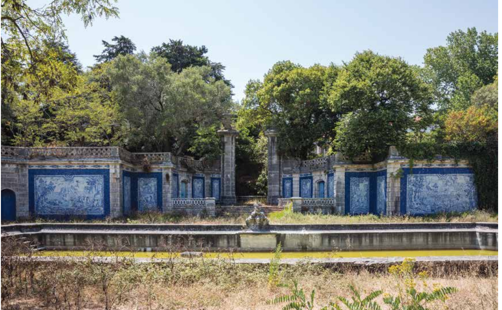
A Cascata da Casa da Pesca e o Tanque da Pesca com os painéis de azulejo, resultado de anos de degradação e abandono
